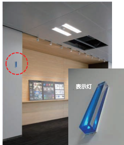
自然換気有効表示灯 (見える化)
