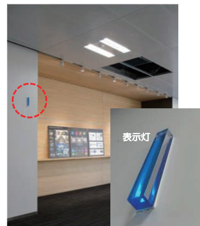
自然換気有効表示灯
