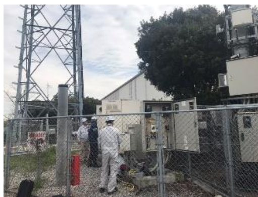
携帯基地局蓄電池
