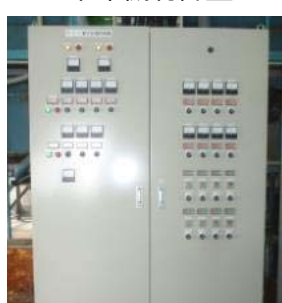
冷凍機制御盤
